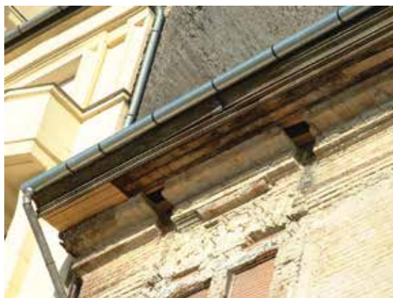
8. ábra: Sérült párkány közelképe felújítás alatt álló épületen. Jól láthatók a téglából falazott párkány szerkezete, illetve az eltávolított konzolok. Helyes megoldás, hogy a balesetvédelmi intézkedéseket követően elsőként a csapadékvíz-elvezető rendszert újítták fel, elejét véve további fagykároknak.
